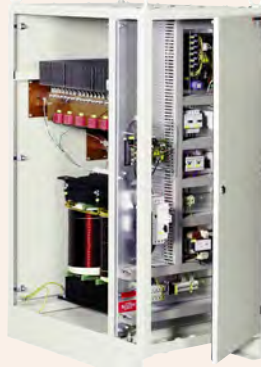
■ Thyristor- oder Schaltnetzteiltechnik
